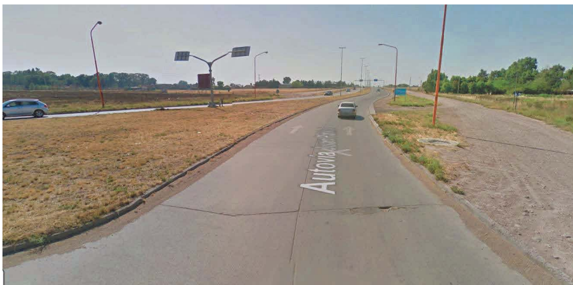
Imagen 3. Deterioro en losas Cno. 007-06 Partido de Bahía Blanca.
